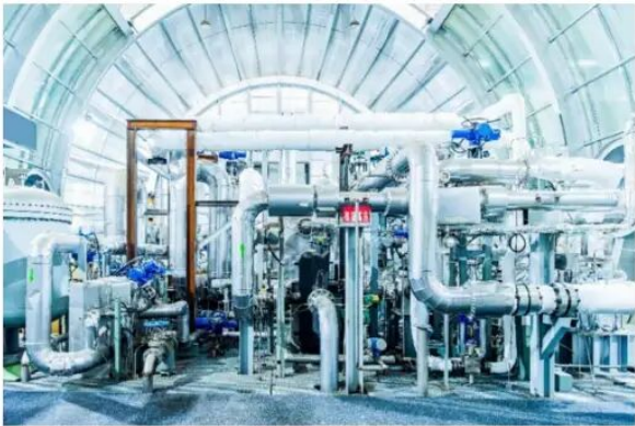
图 4-7 超临界二氧化碳发电技术实验装置
